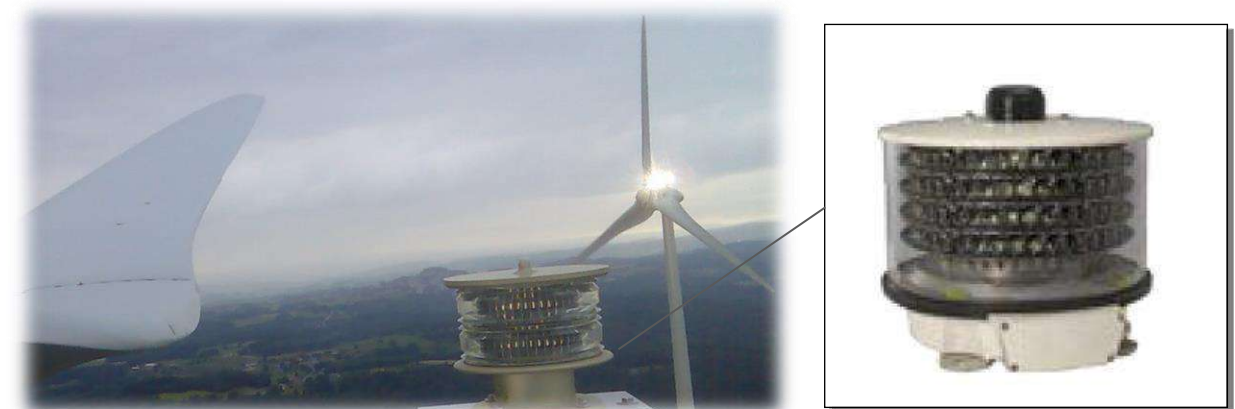
Figure 34 : Balisage d'une éolienne
