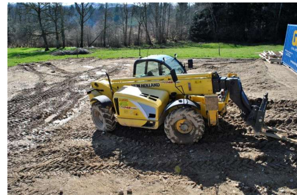
Photographie 29 : Exemple de tassement et d'ornières créés par les engins de chantier (Source : ENCIS Environnement)
